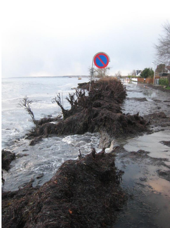
Figur 1.1: Erosion af GI Strandvej under stormen Bodil 5-6. december 2013. Position for billede er vist på figur 2.1.
